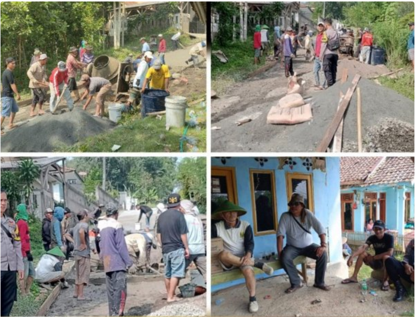
Bhabinkamtibmas Polsek Lengkong Polres Sukabumi Pantau Pembangunan Rambat Beton Jalan untuk Kondusifkan Kamtibmas
